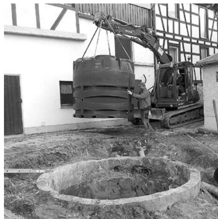
Foto: J. Ninger -Die neue vollbiologische Kleinkläranlage für Gröben
